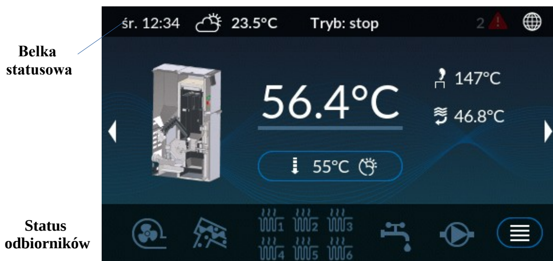
Ilustracja 7: Ekran główny, ekran kotła C.O.
